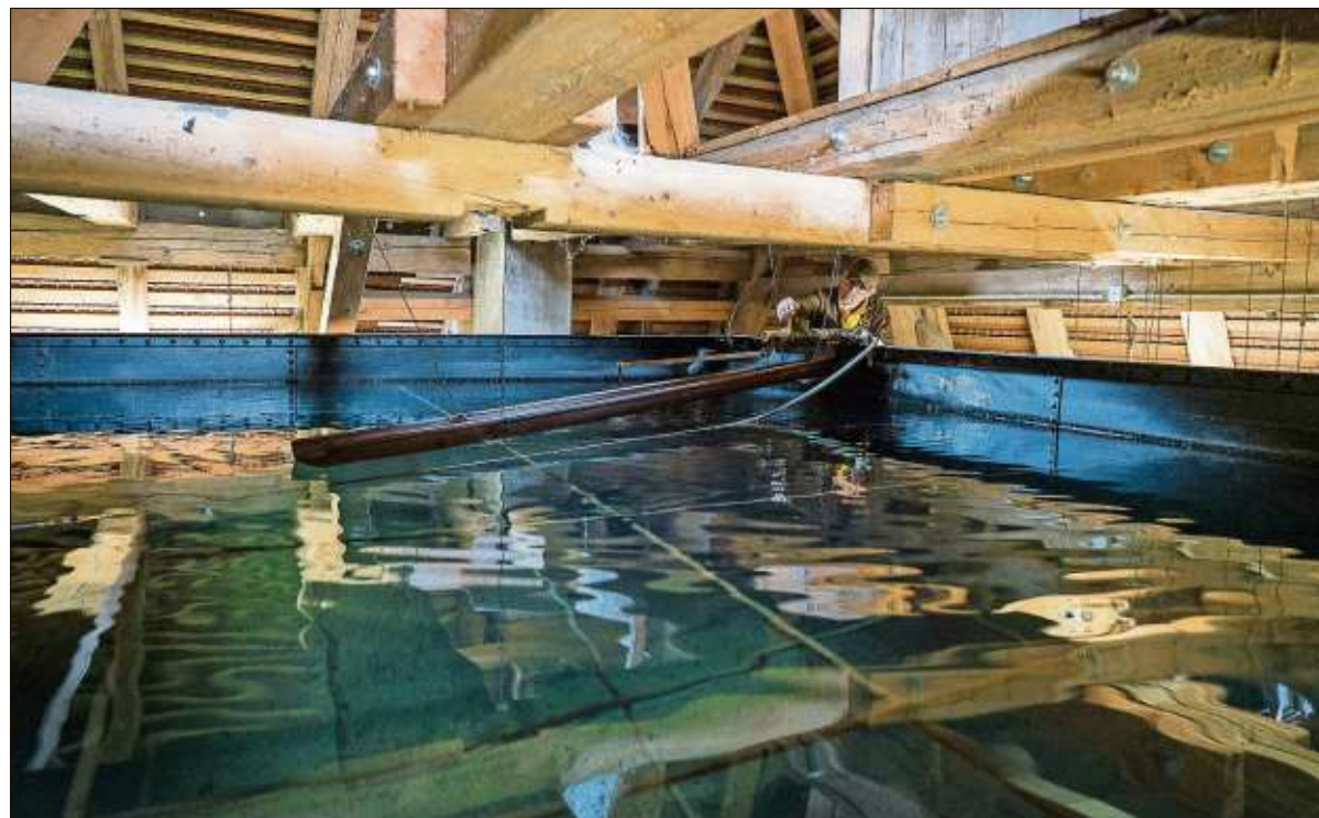
50 000 Liter fasst das eiserne Becken aus dem 19. Jahrhundert, das im Wasserturm eins in 15 Meter Höhe montiert ist. Vorher war das Becken aus Holz, mit gleichem Fassungsvermögen.
